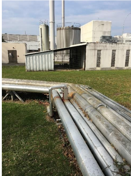
Figure 2-4 : Rack tuyauterie (eau, vapeur et électricité)
